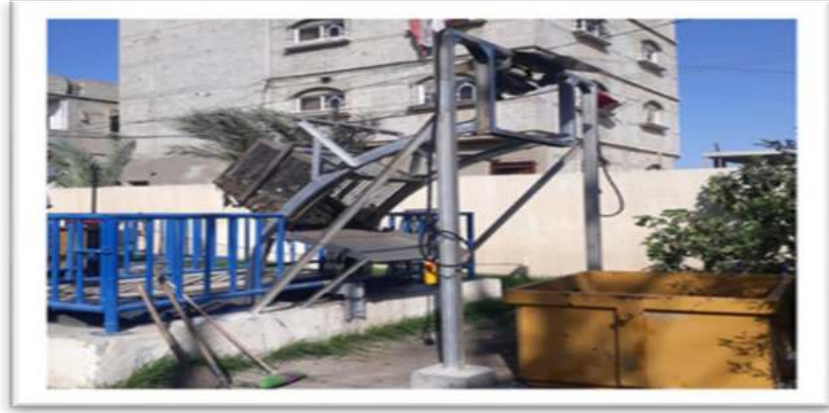
محطة ضخ صرف صحي
